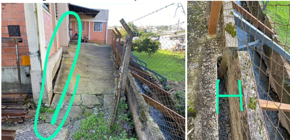
Figura 85 – Muro de contenção cedendo em trecho do Arroio Barracão
