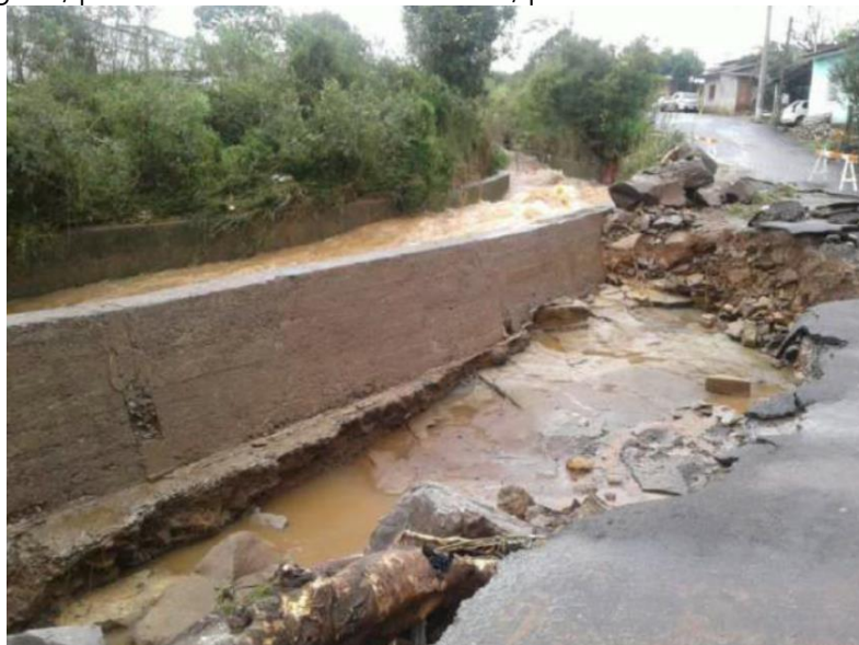
Figura 84 - Trecho da contenção do Arroio Barracão que rompeu devido a força das águas, promovendo danos a estrada, período de maio de 2017
