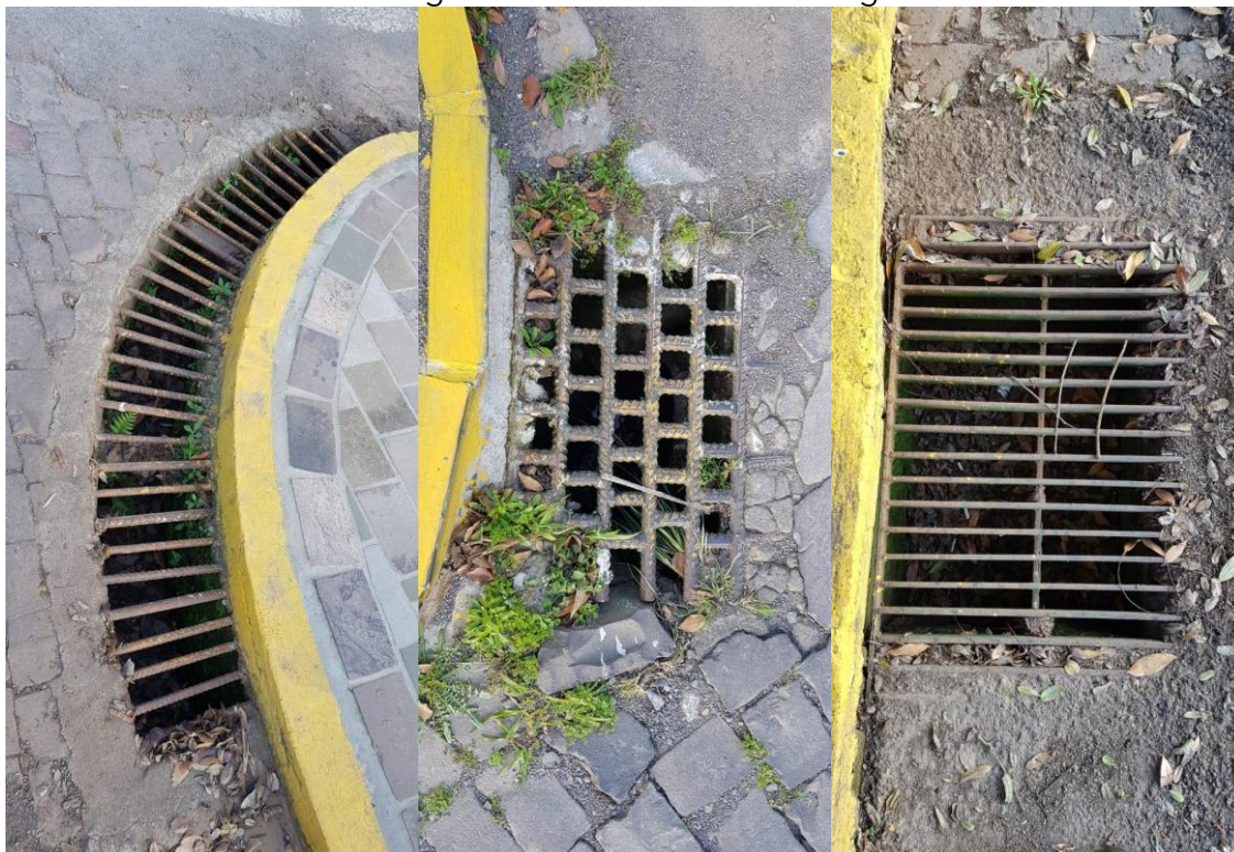
Figura 79 - Bocas de lobo com grade
