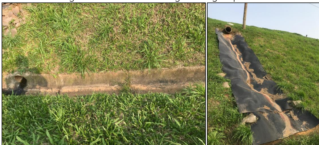
Figura 50 - Sistema de drenagem de águas pluviais
