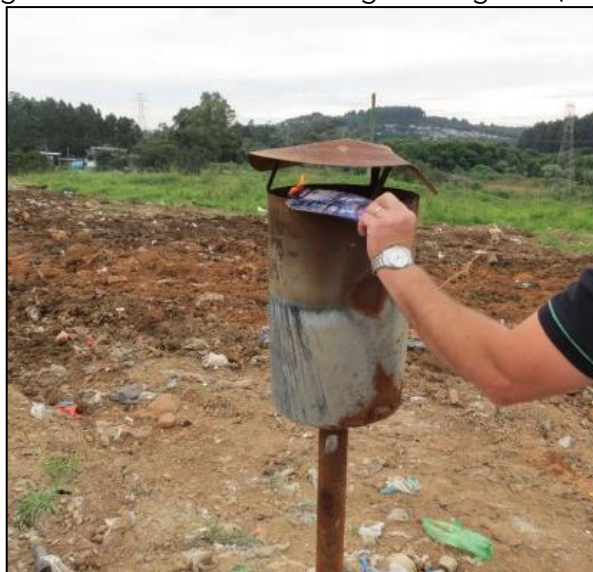
Figura 53 - Sistema de drenagem de gases ( flare )
