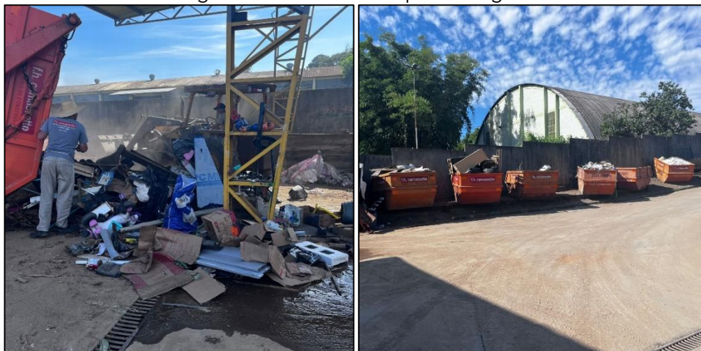
Figura 8 - RCC antes e após a triagem
