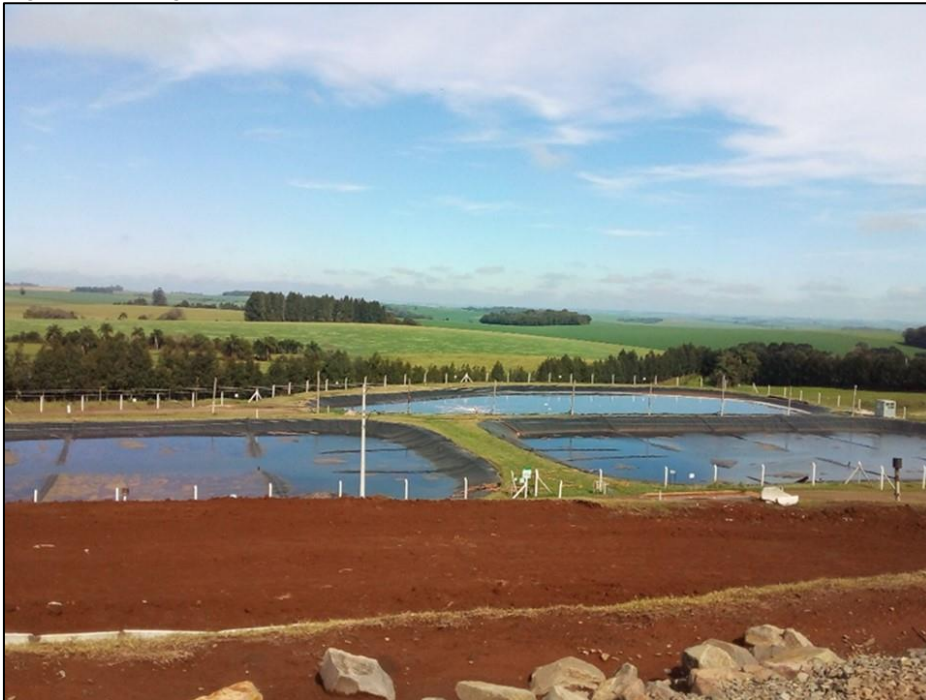
Figura 21 - Lagoas de tratamento do lixiviado
