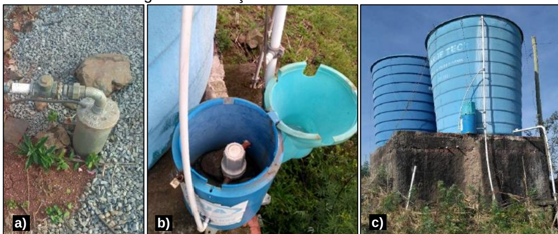
a) Poço de captação; b) Tratamento; c) Reservatório. Fonte: Vila Maria (2020).
