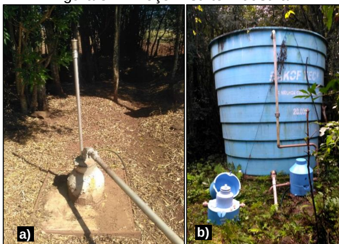
a) Poço de captação; b) Tratamento e reservatório. Fonte: Vila Maria (2020).
