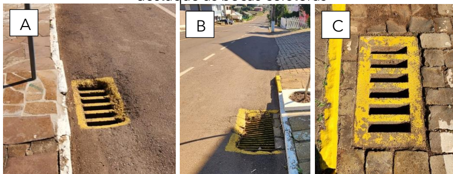
Figura 61 – Sistema de drenagem das águas pluviais do município de Gentil, com destaque às bocas coletoras
