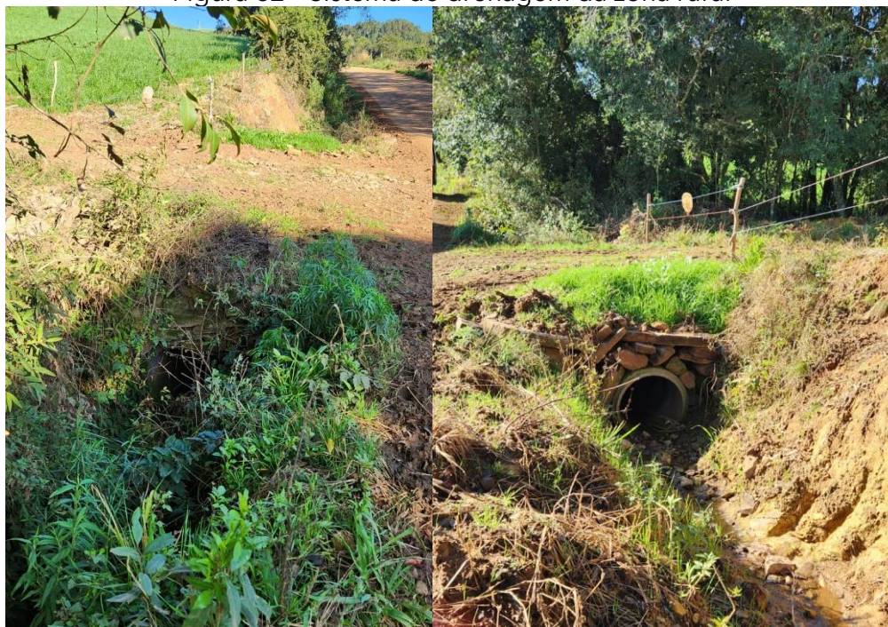
Figura 62 – Sistema de drenagem da zona rural
