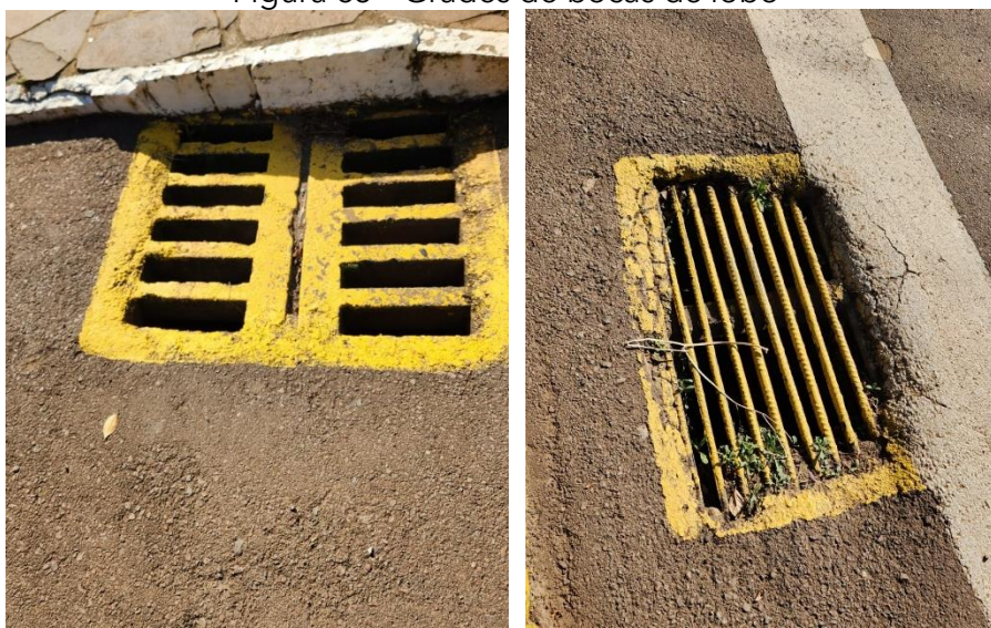
Figura 65 – Grades de bocas de lobo
